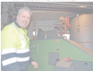
Dette er selve flisfyrkjølen som gir 700 kw. varmeenergi...
